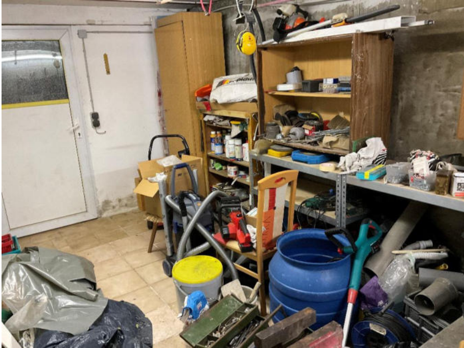
EG Werkstatt , Hangseite, teilweise Feuchtigkeitsschäden
