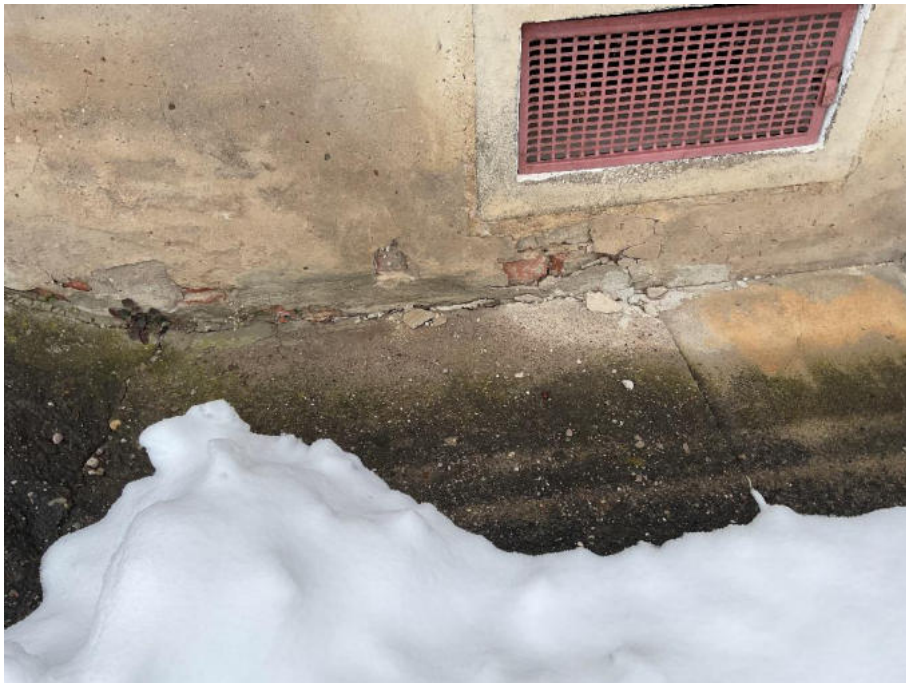
Feuchtigkeitsschäden Fassade – Bereich Keller
