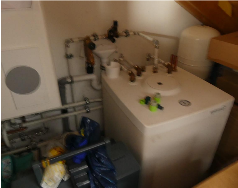
Foto 19: Heizung im Dachgeschoss
