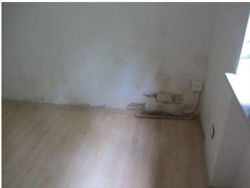
Bild 44: KG: Gästezimmer: feuchte Kellerwand
