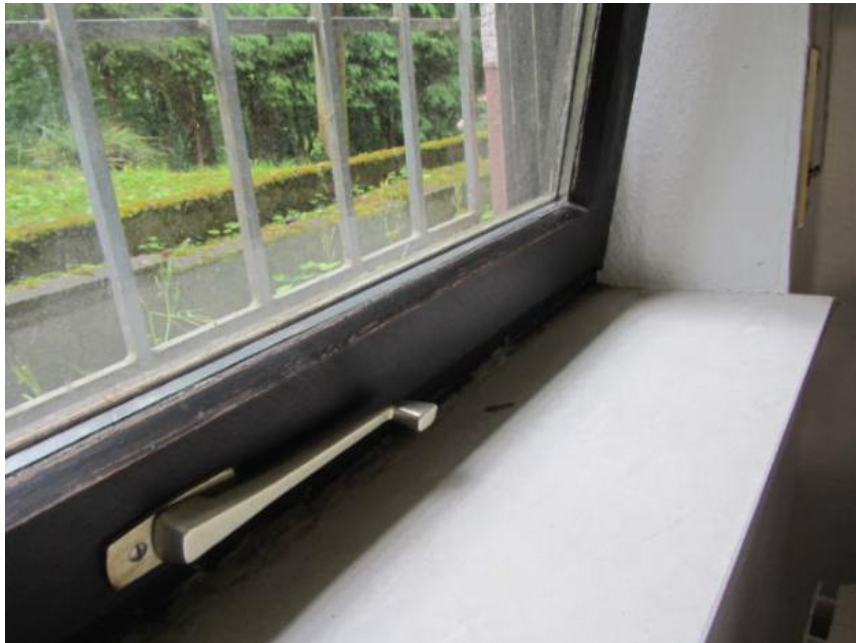
Bild 41: KG: Zustand Holzfenster
