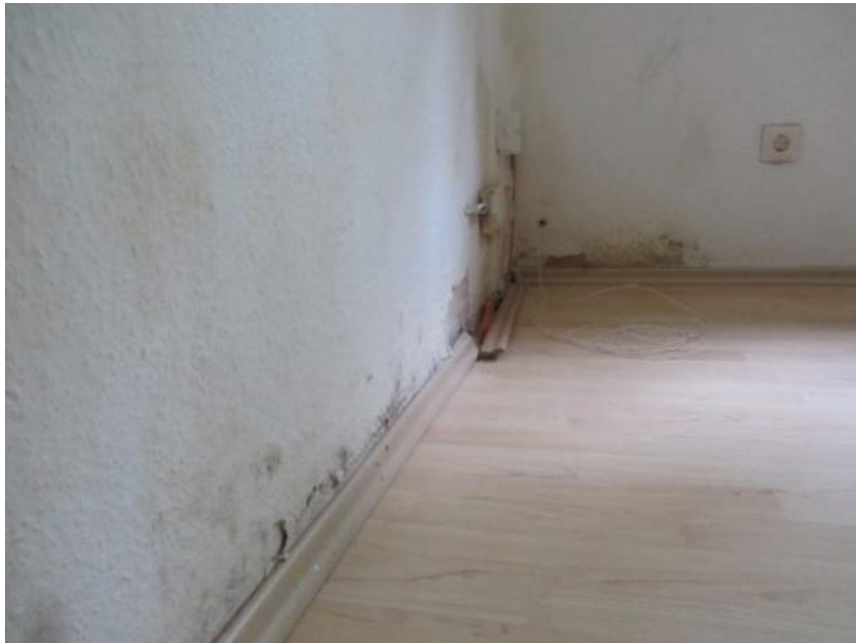
Bild 45: KG: Gästezimmer: feuchte Kellerwand
