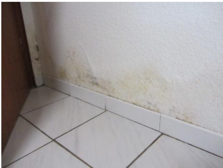
Bild 42: KG: feuchte Kellerwand
