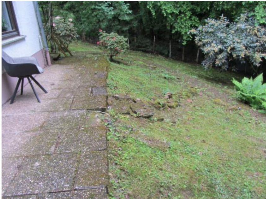
Bild 13: mangelhafte Wegeführung/ mangelhafter Bodenbelag
