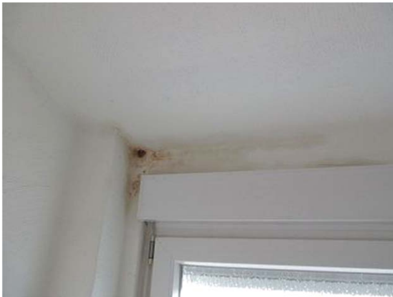
Feuchte Bereich Gaube
