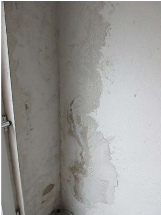
Feuchte Bereich Außenwand KG
