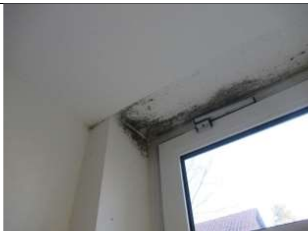
Geb. 1, EG: Küche: Schimmel
