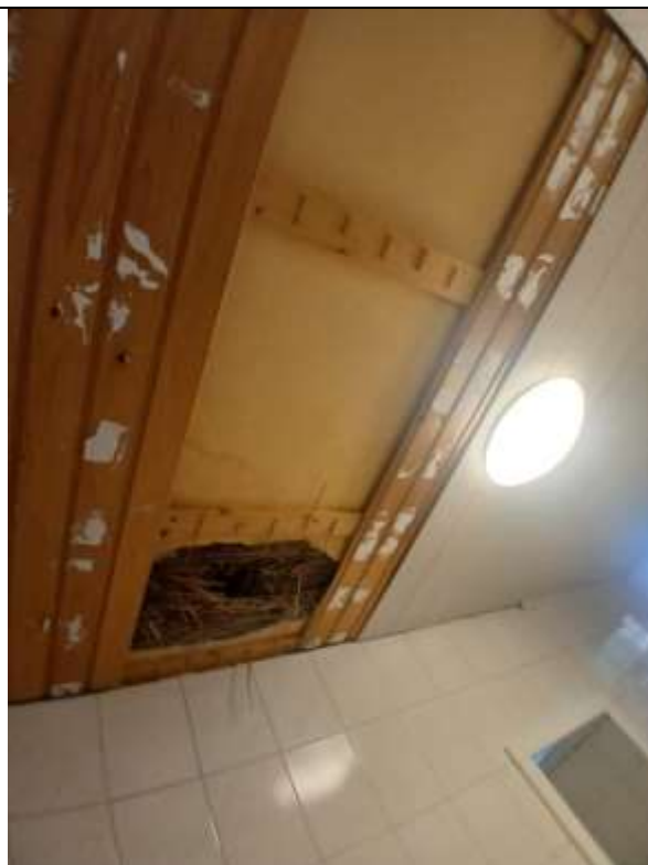
Schadstelle an Decke Bad
