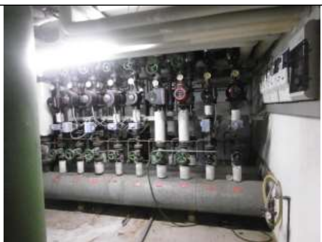
Geb. 2, KG: Heizungsverteilung
