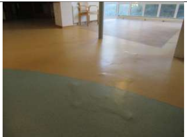
Geb. 3/4, EG: Flur: unebener Boden
