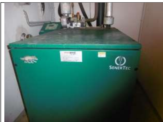
Geb. 2, KG: Blockheizkraftwerk (1 von 2)
