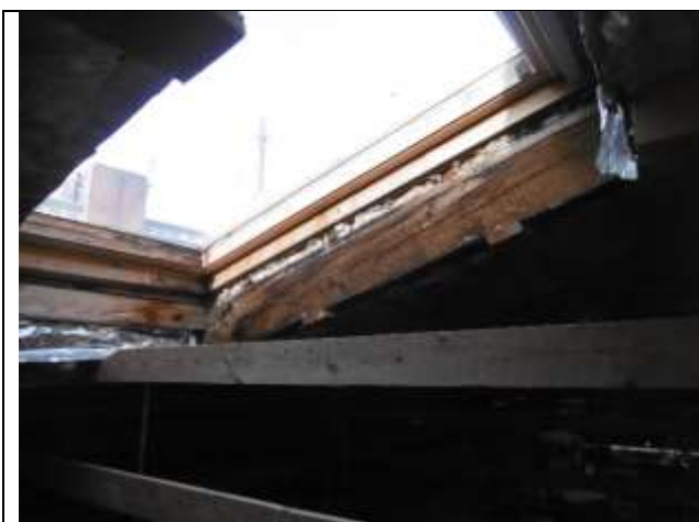
Geb. 3: undichtes Fenster im Dachboden
