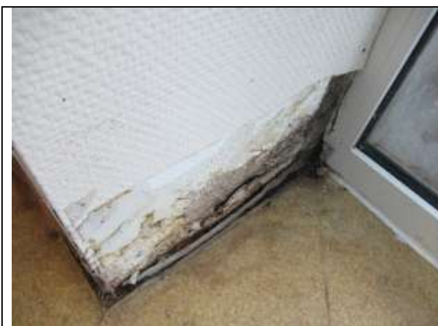
Geb. 3/4, EG: Flur: Schimmel
