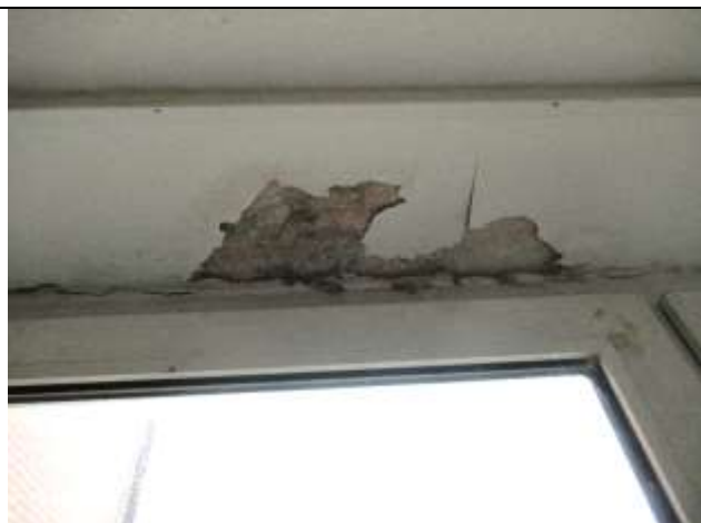
Geb. 2, 1. OG: Schaden vor Lastenaufzug
