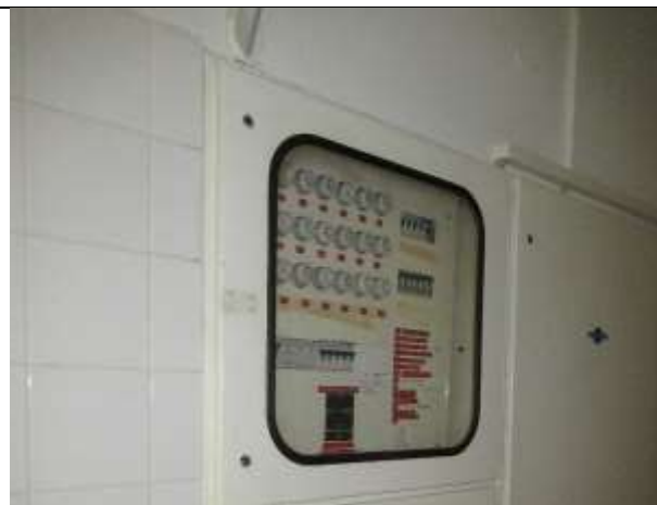
Geb. 1, EG: Küche: Sicherungen
