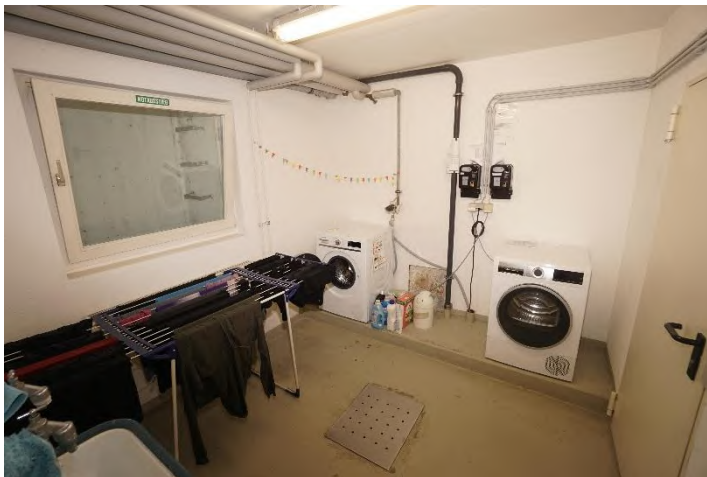
Wasch- und Trockenraum
