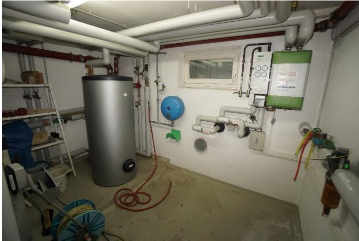
Heizungsraum mit Fernwärmeübergabestation
